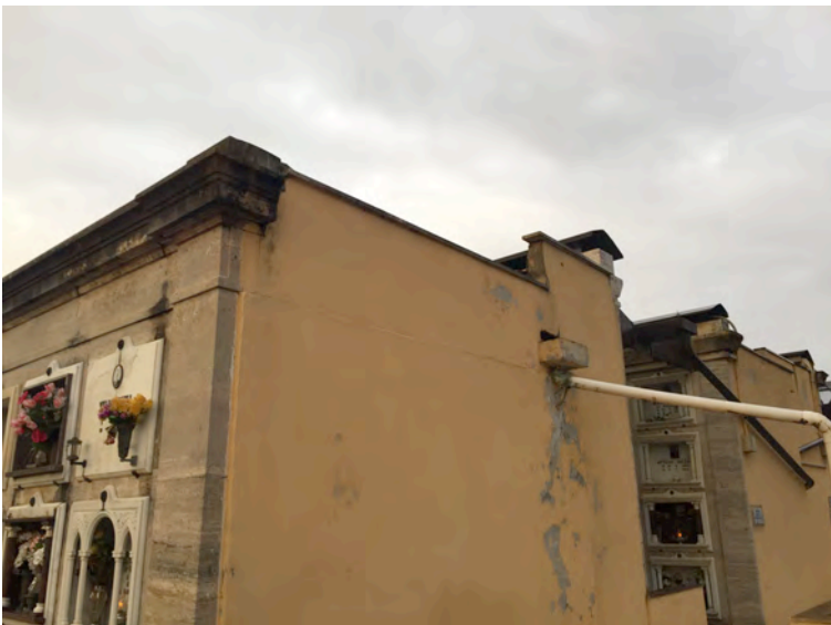
Pluviale in PVC da rimuovere
